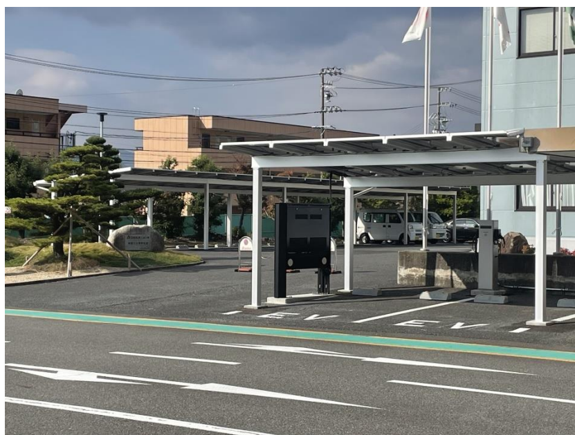
(上) ADEKA三重工場遊休地に設置・発電開始した野立て太陽光発電設備 (下) 同 駐車場に設置・発電開始したEV充電器とソーラーカーポート
