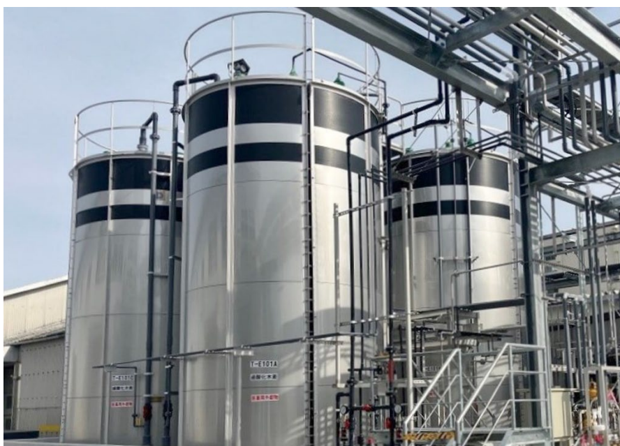
▲ 富士工場で竣工した生産設備（外観）
