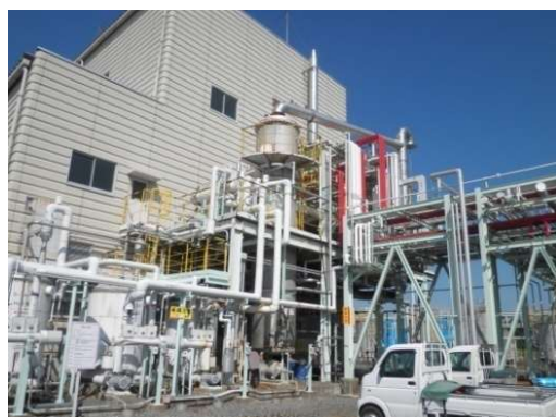
第一生産プラント排ガス処理設備
