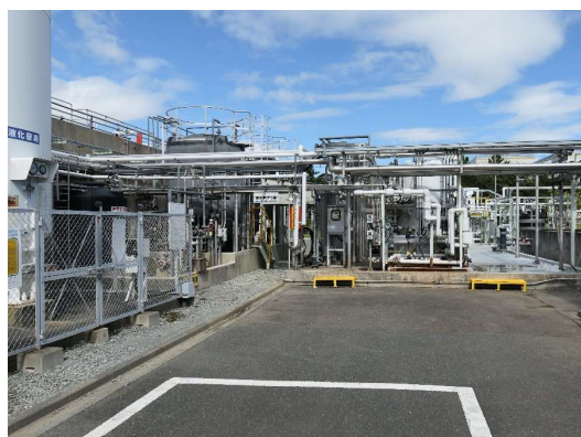
排水処理設備
