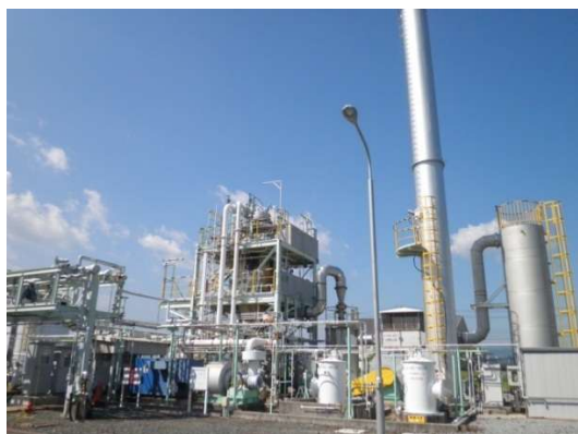
第一廃液燃焼設備
