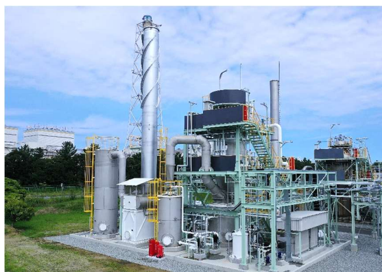
第二廃液燃焼設備
