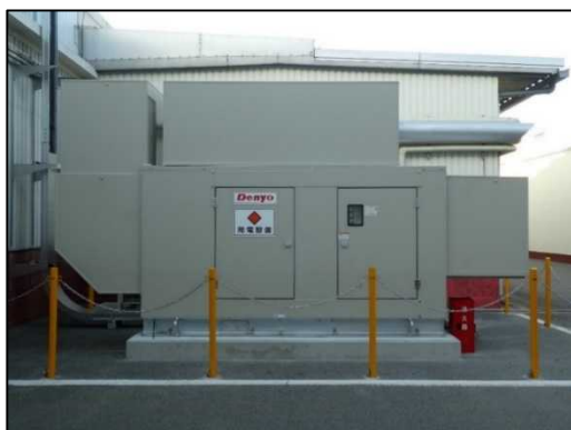
非常用発電機
