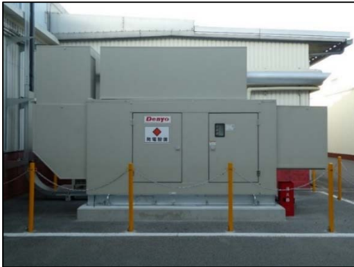
非常用発電機
