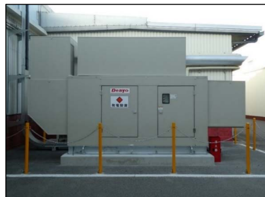
非常用発電機
