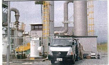
廃棄物焼却炉ばいじんフィルターと排ガス測定風景
